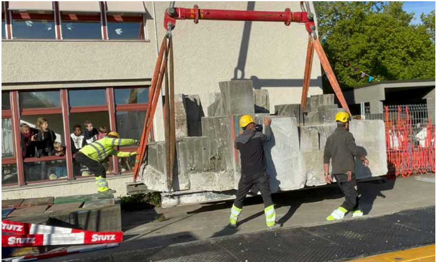
Er war ein beliebter Spielplatz, insbesondere an heissen Tagen: Der Brunnen auf dem Platz beim Schulhaus Nest 1. Mit den beiden Becken und einem Wasserspiel wurde er 1967 als künstlerisches Werk von Fredi Thalmann in Beton gegossen. Jetzt wartet der Brunnen vor diesem Klassenzimmer auf seine neue Bestimmung.
